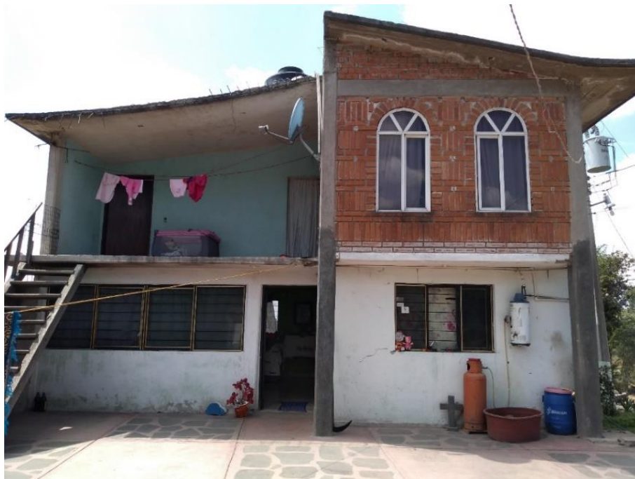
Fotografía 8. Losa fracturada y posiblemente flechada en vivienda con daños por los sismos en Estado de México
