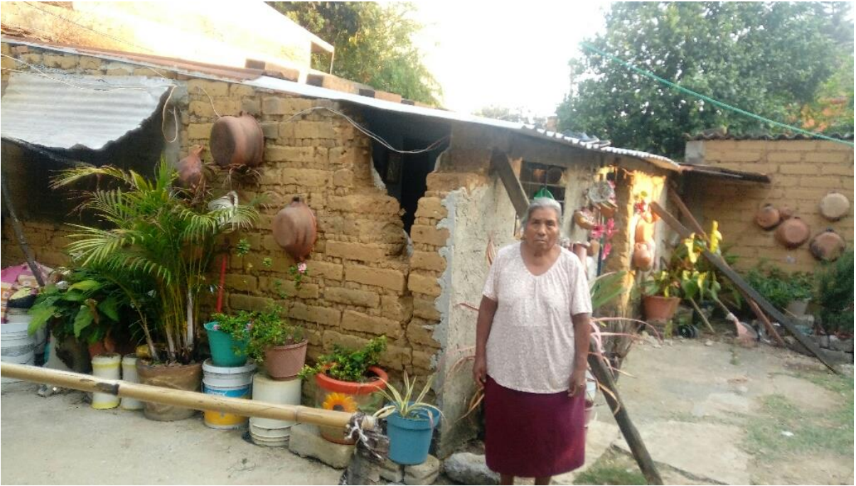
Fotografía 11. Polines deteniendo un muro en vivienda identificada con daños por sismos en Morelos.
