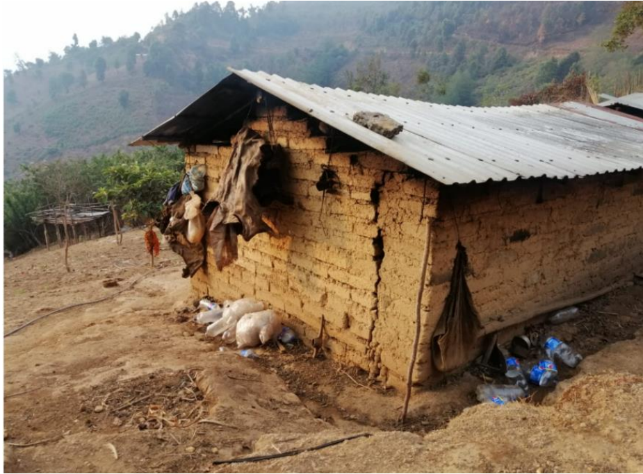
Fotografía 7. Vivienda con daños en Guerrero
