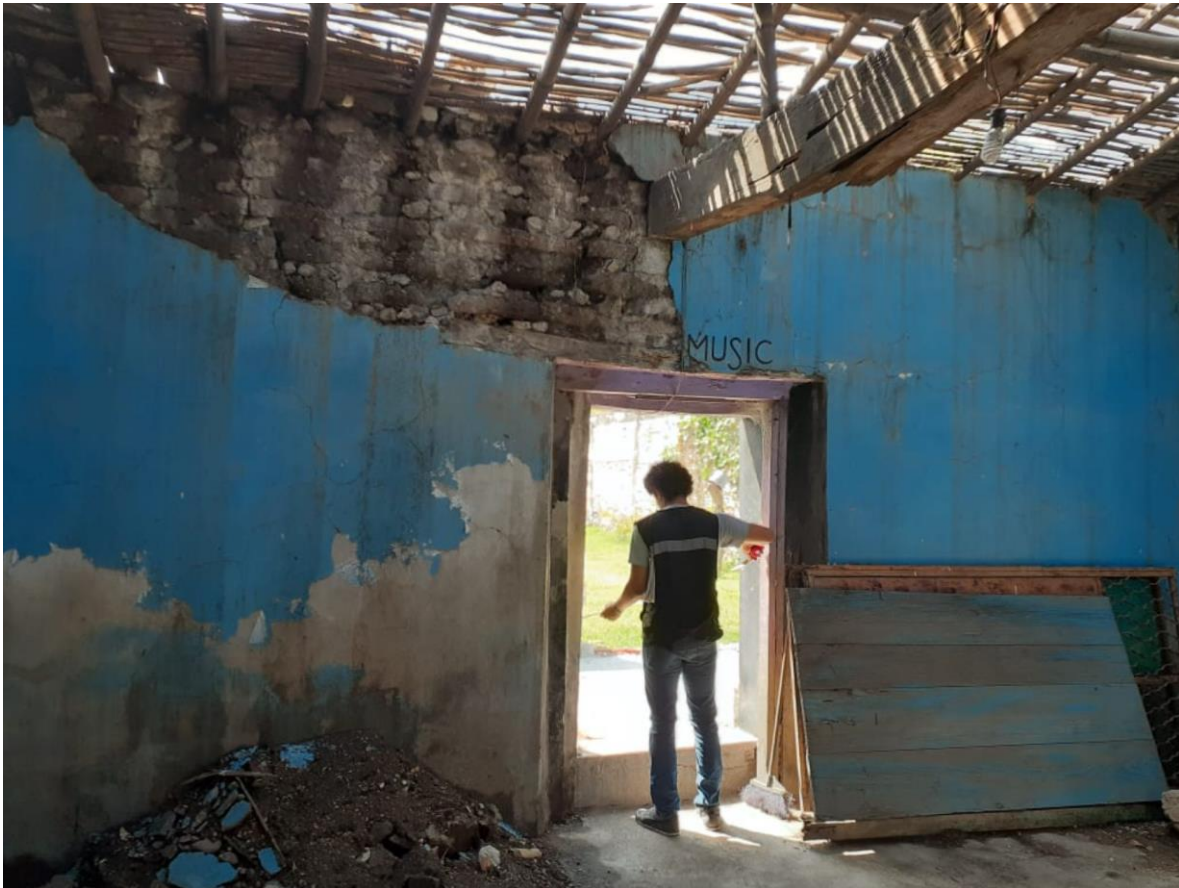
Fotografía 15. Levantamiento de daños en la vivienda en Puebla
