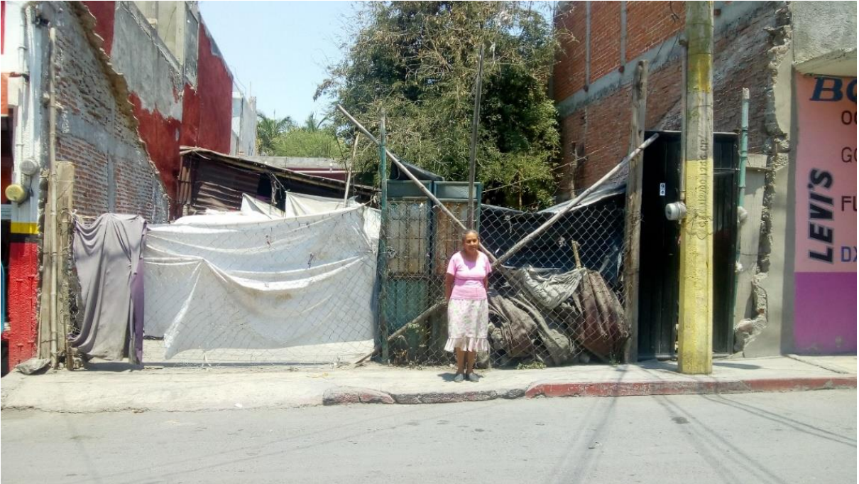
Fotografía 9. Pérdida total de la vivienda por los sismos en Morelos.
