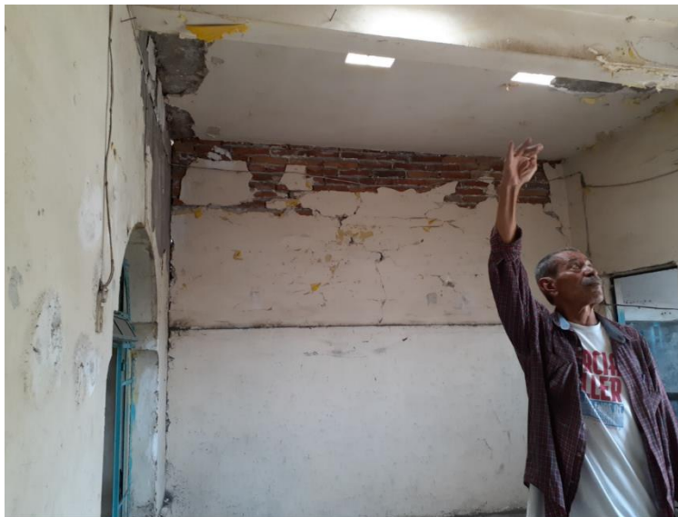
Fotografía 6. Vivienda con daños por los sismos en Puebla
