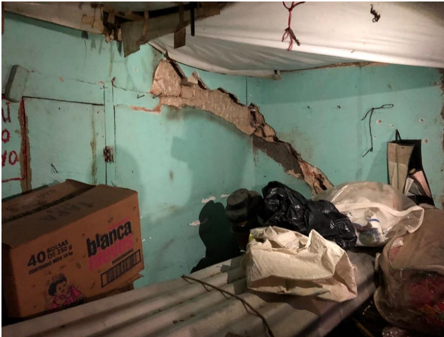
Fotografía 13. Vivienda sin cubierta y con muros fracturados a causa de los sismos en Chiapas
