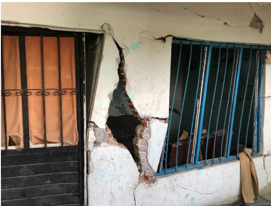
Fotografía 14. Falla estructural por falta de confinamientos en vanos en vivienda dañada por los sismos en Chiapas.
