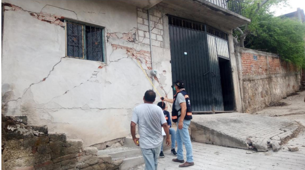
Fotografía 5. Identificación de viviendas dañadas por los sismos en Guerrero
