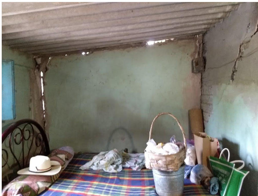
Fotografía 10. Separación de los muros existentes de los elementos estructurales que confinan la mampostería en una vivienda identificada con daños por los sismos en Morelos
